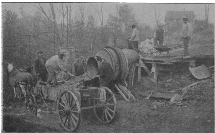
Mezclador de concreto que funciona en la construcción de un camino en terrenos de la Universidad de Cornell. — El mezclador se está cargando por un extremo y descargándose en un carretón por otro.
